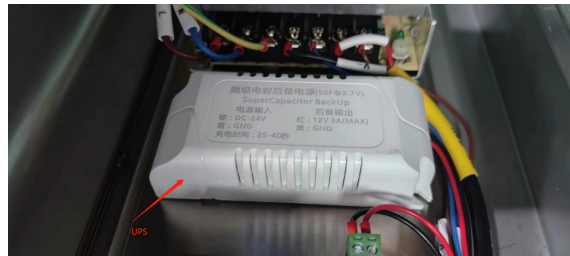
外置 UPS (蓄电池)
