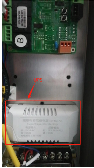
红框为外置 UPS（蓄电池）
